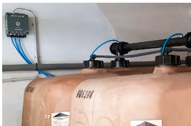
Bild 2: Links oben im Bild ist die Sensorbox des „secu4“. Diese Einheit erfasst die Heizölpegel in den Batteriebehältern.
